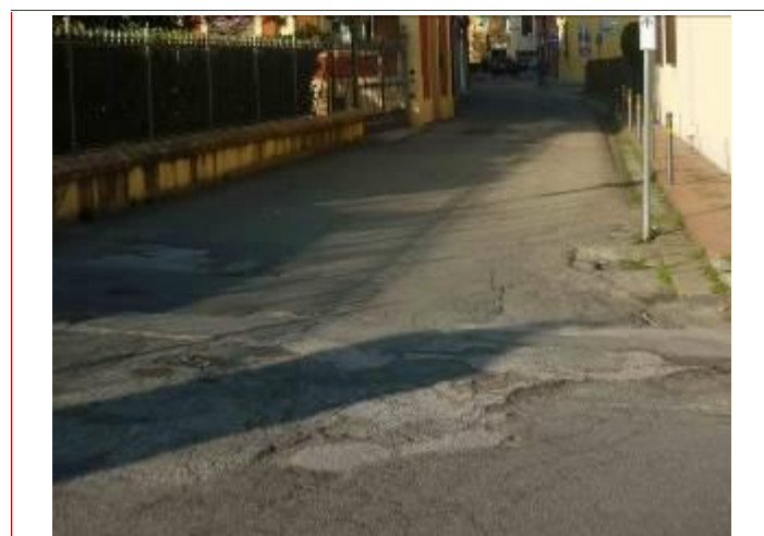
35 Pavimentazione stradale deteriorata. Mancanza della linea bianca di carreggiata.
