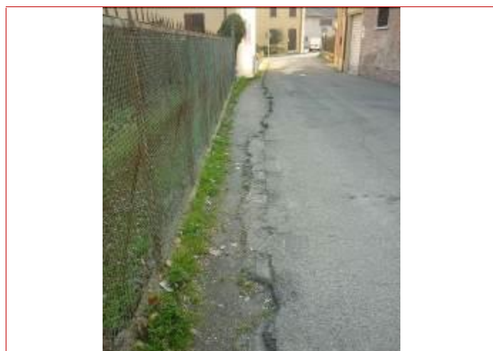
34 Pavimentazione stradale deteriorata e mancanza di idonea corsia di transito pedonale. Mancanza della linea bianca di carreggiata.
