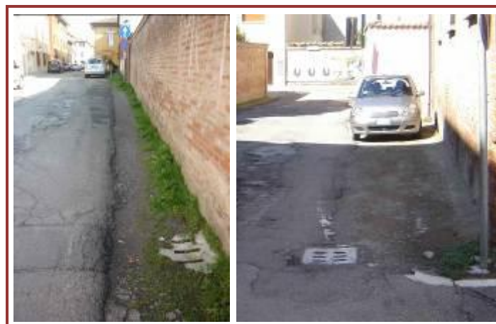
10 Ingresso al Borgo storico. Manto stradale deteriorato, assenza di strisce segnaletiche di carreggiata e assenza di marciapiede con conseguente carenza di sicurezza ai pedoni.
