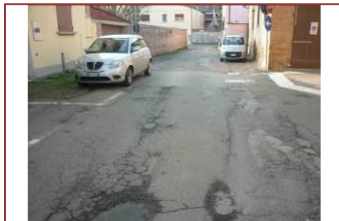
08 Ingresso al Borgo storico. Pavimentazione stradale ormai deteriorata dal tempo e dalla scarsa manutenzione. Linee bianche di limite carreggiata sbiadite o già del tutto scomparse.
