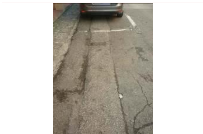
14 Pavimentazione stradale deteriorata in più punti in via Larga Castello. Linee bianche di parcheggio sbiadite, in alcuni tratti ormai scomparse.
