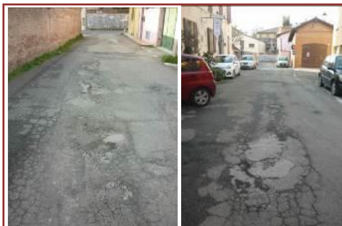
09 Manto stradale deteriorato in molteplici punti in ingresso al Borgo anche a causa del transito di grossi automezzi compattatori e commerciali.
