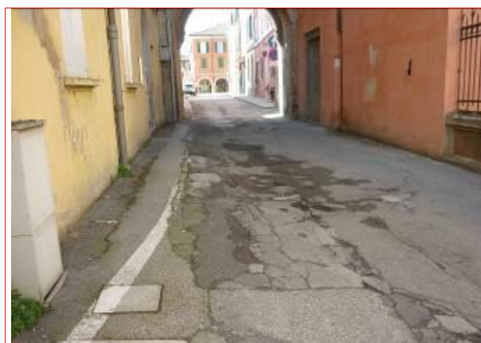
16 Manto stradale martoriato in vari punti in via del Borgo, specialmente sotto la Torre dell'Orologio in uscita veicolare dal Borgo storico.
