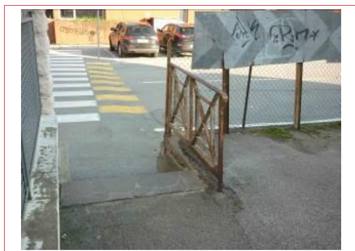
36 Scala che conduce all'area scolastico-sportiva, poco funzionale e con una ringhiera datata al limite delle norme di sicurezza.
